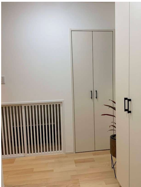
床下冷暖房は階段下に設置し、格子戸で目隠ししている
