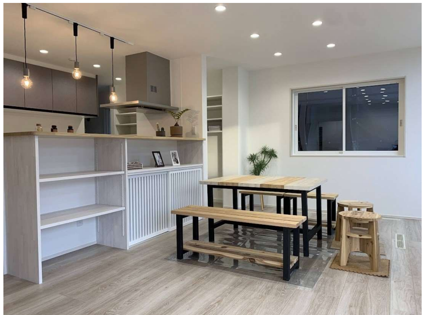
床下冷暖房はキッチン対面下部に設置し、格子戸で目隠し
